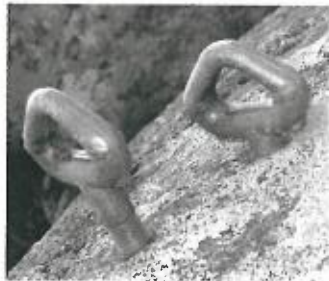
Eksempel på feil montering
